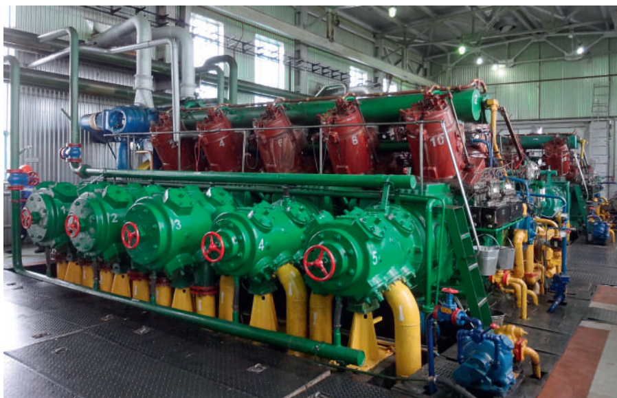
Рис. 1. Газомотокомпрессор типа 10 ГKH
